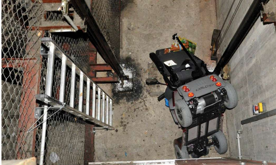
Aus zahlreichen Ländern wurde von schlimmen Unfällen berichtet: Personen auf einem Scooter prallten gegen die geschlossenen Türblätter von Schachttüren und stürzten direkt in die Tiefe.
